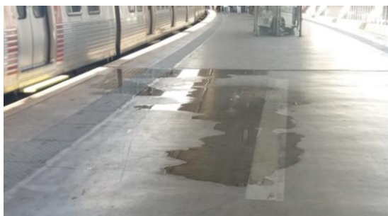
Figura 4.9 – Infiltrações na estação de Entrecampos (plataforma).
